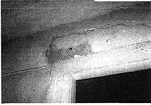
két szoba közötti ajtó fölött repedés és vakolat leválás
