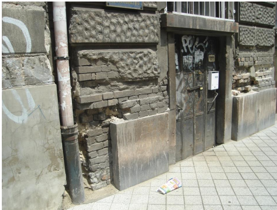
Hiányzó kőtábla, károsodott kváderes vakolat és falazat, rossz állapotú pincaajtó
