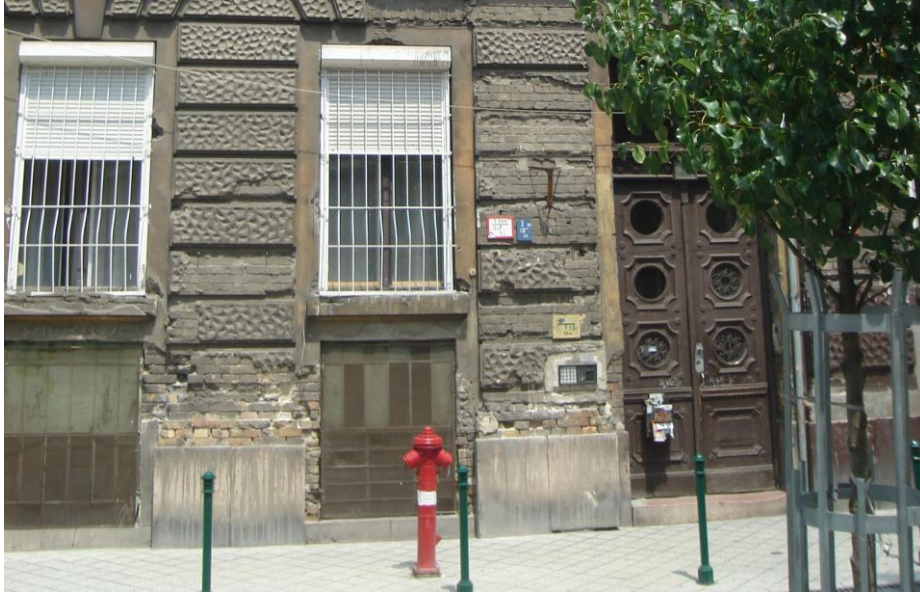
Károsodott lábazati rész, fa kapu, szögacél ablakok
