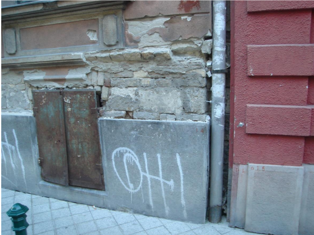
Károsodott vakolat, kő falazat, műkő lábazat, pinceablak
