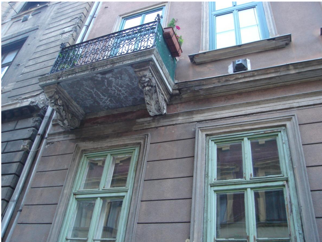
Erkély alatti leázás, károsodott övpárkány, előregeedett kapcsolt gerébtokos ablakok
