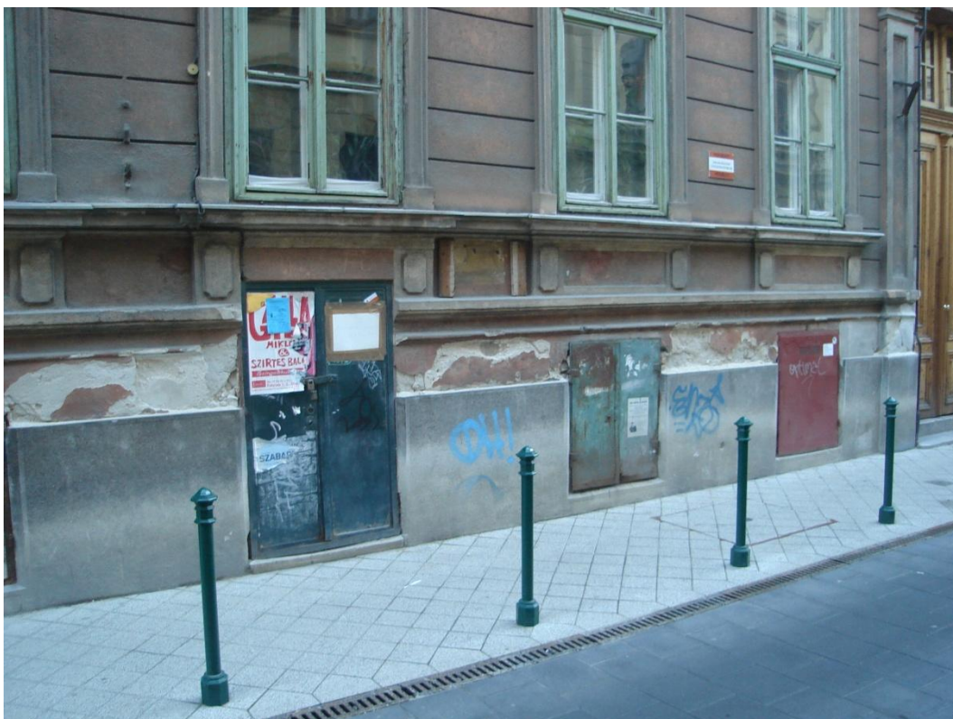
A lábazati kár a homlokzat teljes hosszán végighúzódik
