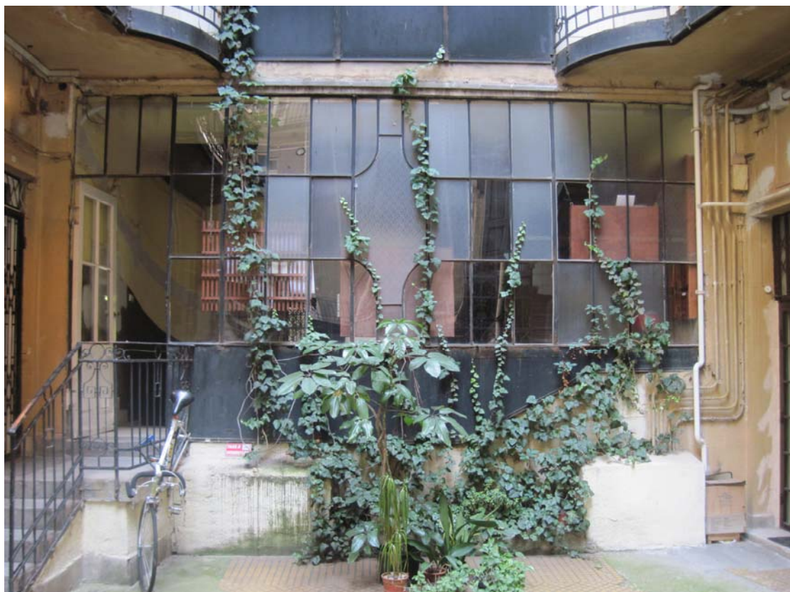
meglévő állapot lépcsőházi nyílászáró
