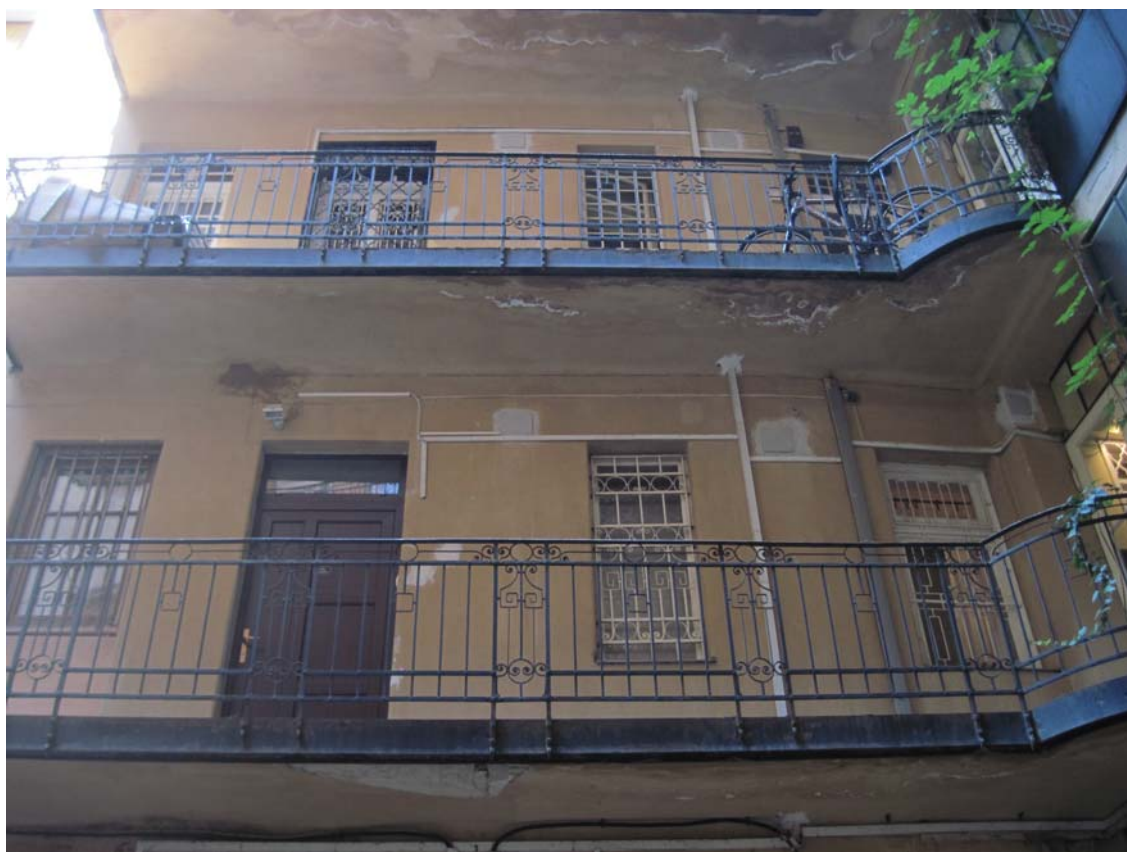
meglévő állapot függőfolyosó lemez vakolat leválások
