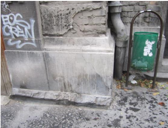
Lábazat baloldali rizalitnál, az alsó erősen töredezett, hiányos, a felső sarkán repedés
