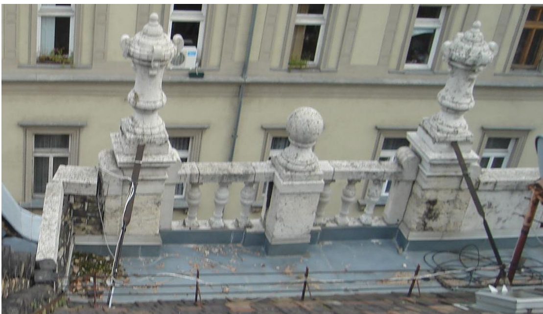
A tűzfal attikafala degradálódott, következménye a mellvédelemek kimozdulása is.
