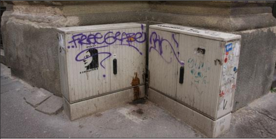
ELMU kapcsolószelekrény a Gutenberg tér felőli homlokzat előtt.
