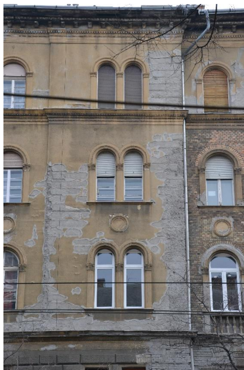
5.sz. kép: A felújítandó homlokzaton a vakolat nagy felületeken hiányos.
