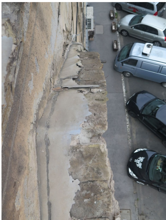
Korrodált, hiányos pátkányfedés
