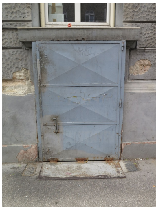
Korrodált acél pinceajtó
