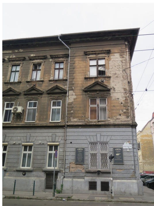
Vakolat hiányos rizalit, hiányzó armírozás
