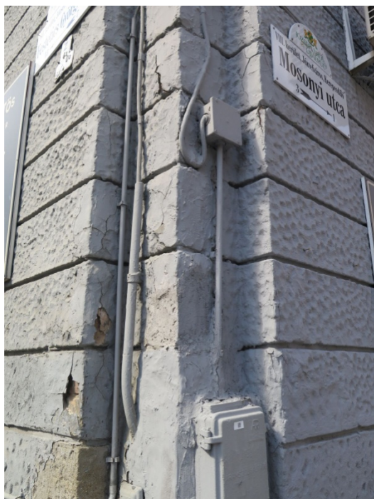
Elektromos vezetékek falon kívül
