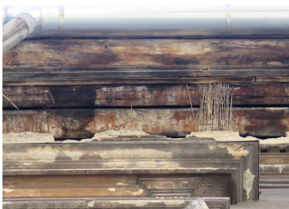
Leszakadt nád struktúr, fa koronázó párkány
