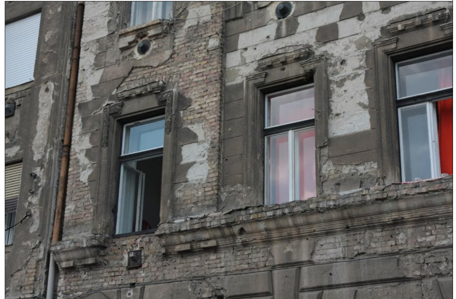
Jelenlegi állapot. Jobb oldali rizalit, 1 emelet és az osztópárkány.
