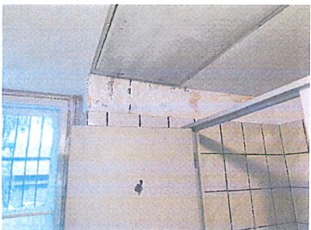
25. ázási nyomok a falszerkezeten
