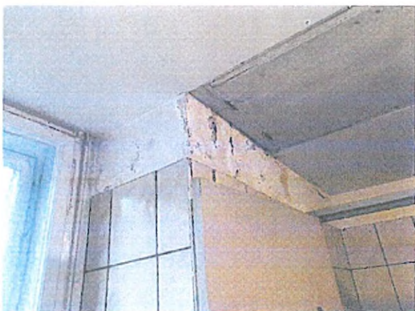
24. ázási nyomok a falszerkezeten
