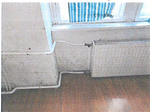
22. ázási nyomok a falszerkezeten
