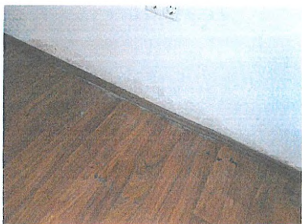
23. ázási nyomok a falszerkezeten
