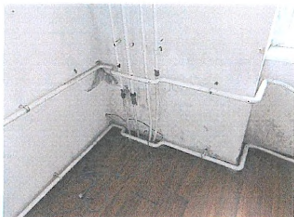
21. ázási nyomok a falszerkezeten
