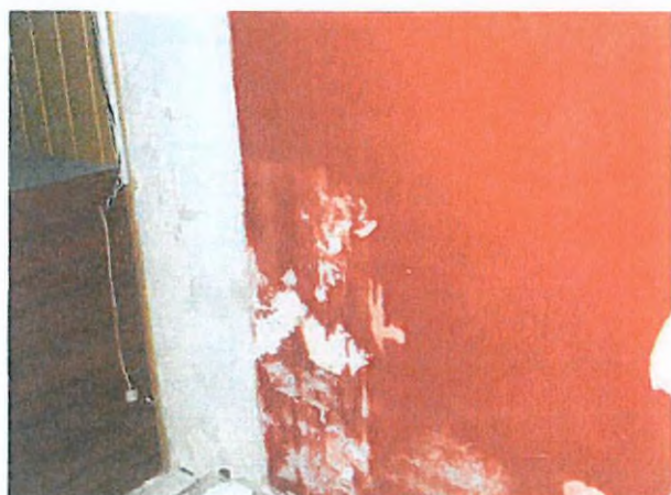
12. vízesedési nyomok a falszerkezeten
