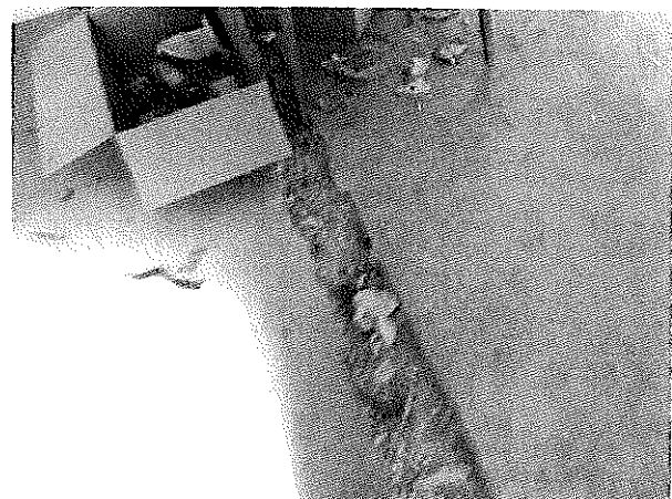
23. félbemaradt felújítási munkák
