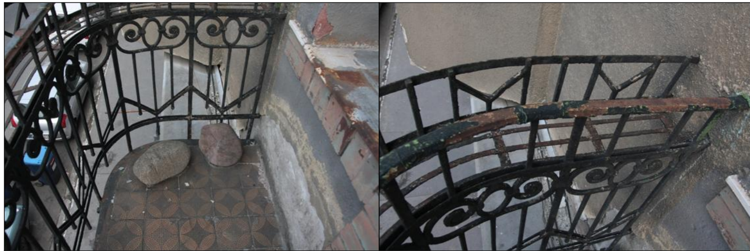
Az 1. emeleten a jobb szélső teraszon fotózott, eredeti korlát és virágláda tartó
