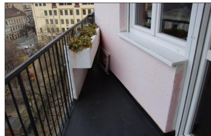
A hegyesszögben végződő főhomlokzati teraszok csücske, a hegyesszögbe behatoló vasbeton virágtartókkal. Itt (7.1 lakás) az eredeti burkolat (le festve) és az egyébként sok lakásban cserélt nyílászáró is megfigyelhető.
