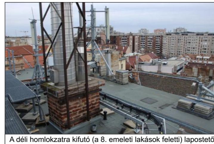
A főhomlokzat feletti padlás a 8. emeleten és a csatlakozó lapostető vasbeton födéme és peremgerendája
