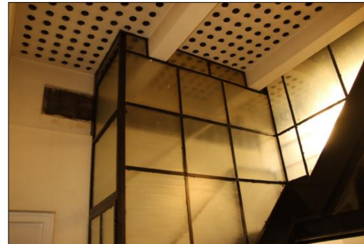
A lépcsőház felső lehatárolása, az eredetileg bevilágító üvegtéglákkal öntött födém. A függőnyfalon túl a bevilágító udvar van.
