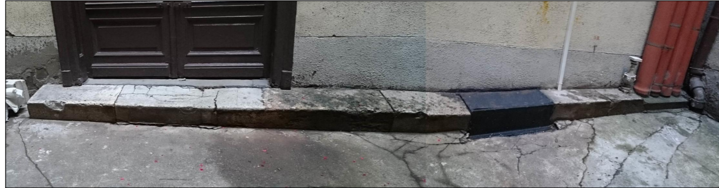
Bontandó kő/beton fellépő pincszellőzővel. Új, vasalt beton fellépő lesz. A belső udvar bejárata előtti tömbkő/beton fellépő.
