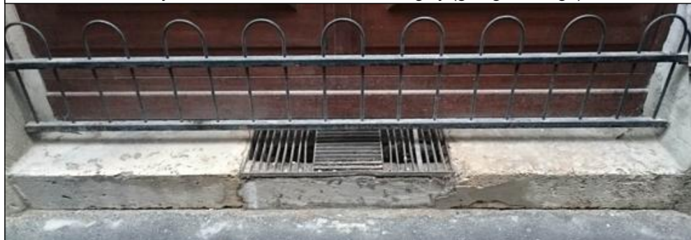
Meglévő kő fellépő pincszellőzővel. Tisztítás, polírozás, beton bontás. A rácsot le kell szerelni, helyette nem készül új szerkezet. Kölcsey utca, a József körút felőli 4. tengely (zeneműbolt).
