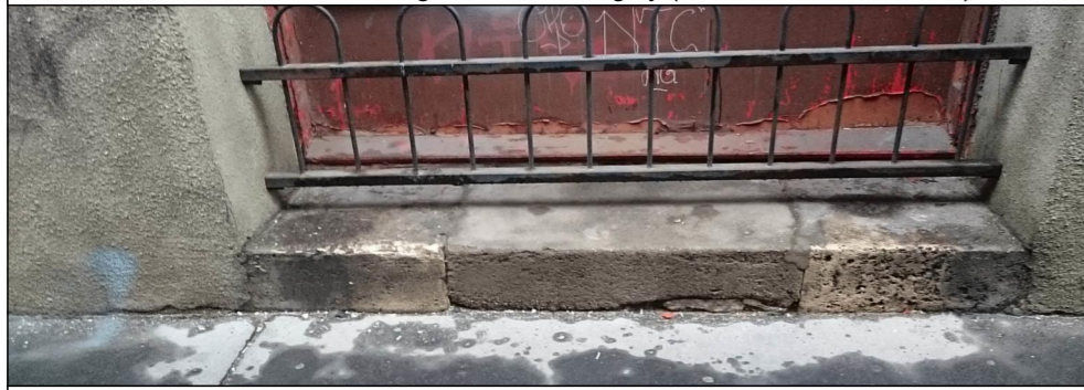
Meglévő kő fellépő. Tisztítás, polírozás, beton bontás. Középen új kő. A rácsot le kell szerelni, helyette nem készül új szerkezet.
