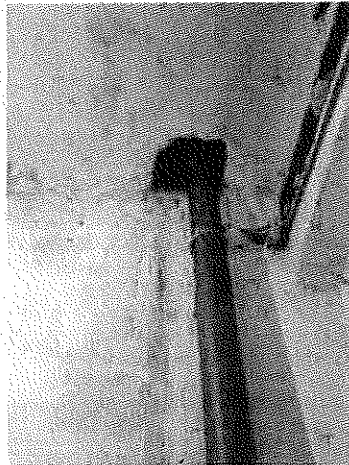
A felszálló PVC strang a földszinten, földémsíkban Y elággal az emeleti WC-k számára
