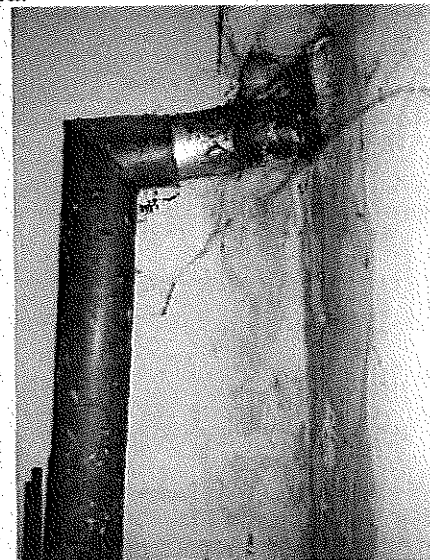
Láthatóan a falban elkorrodált, szivárgó tető lefolyócső, szakszerűtlen toldással
