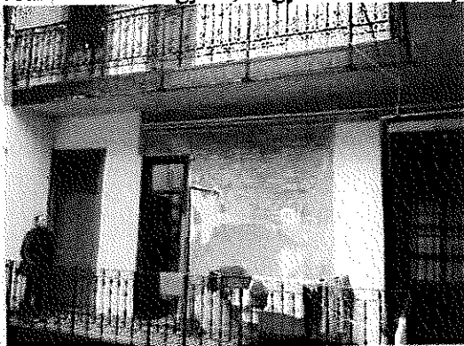
Lefagyott hiányzó vakolat az I. emeleti udvari homlokzaton
