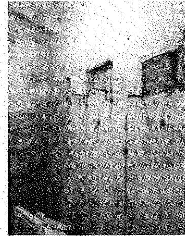
A közös WC a földszinten használaton kívül, falai vizesek
