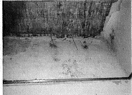
A hátsó tűzfal a szoba felől is vizes, a fafödém alatt a vakolaton penészgomba foltok láthatóak
