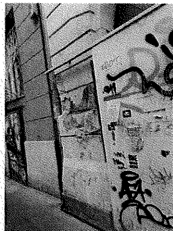
07. esővízcsatorna okozta károsodás
