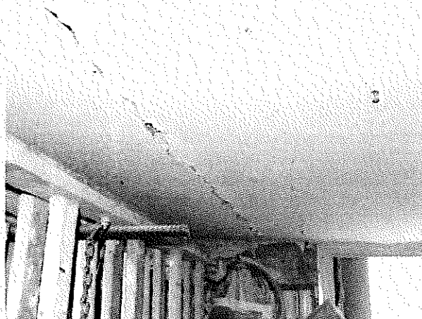
11. repedések a födémszerkezeten
