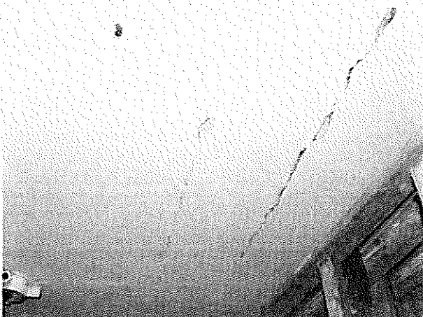
10. repedések a födémszerkezeten
