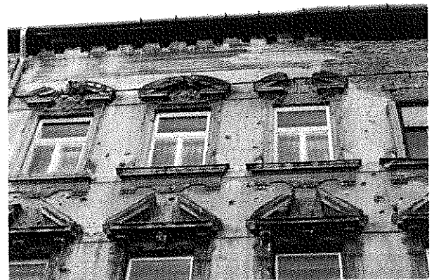
06. hiányzó díszítések, korhadt deszkázat
