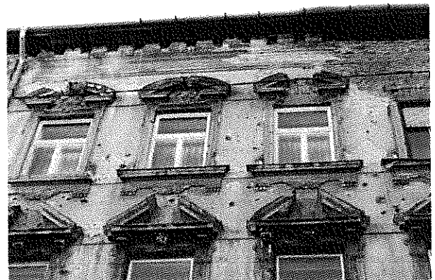
06. hiányzó díszítések, korhadt deszkázat
