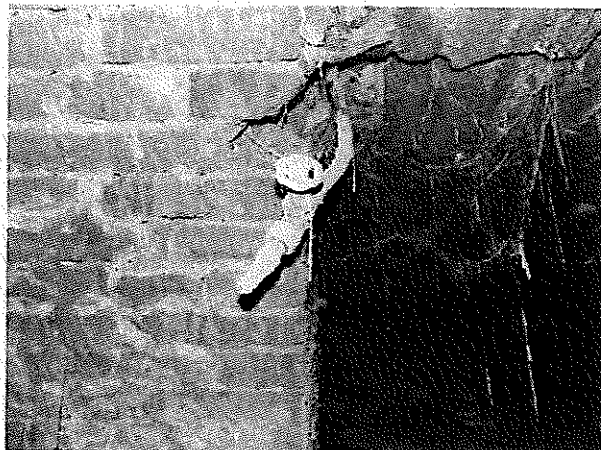
07. belső tér vízvezeték
