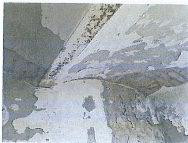
17. vakolathibák a pince földémszerkezetén
