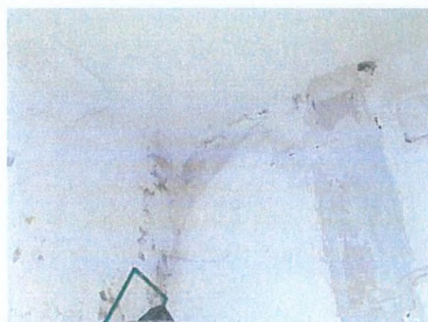
10. vakolathibák a falszerkezeten
