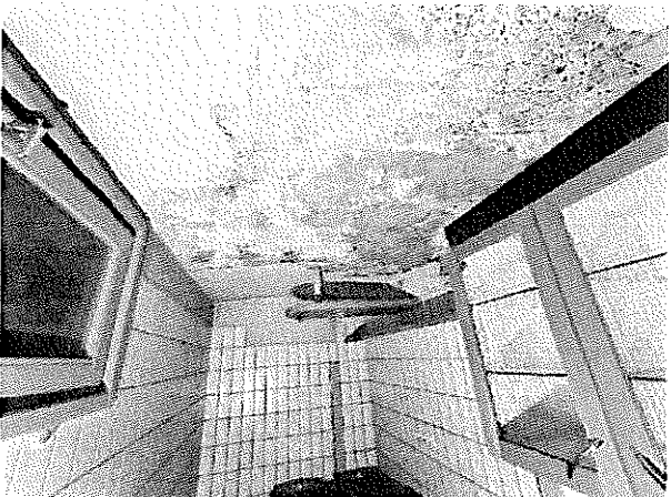
22. vakolathibák a födémszerkezeten
