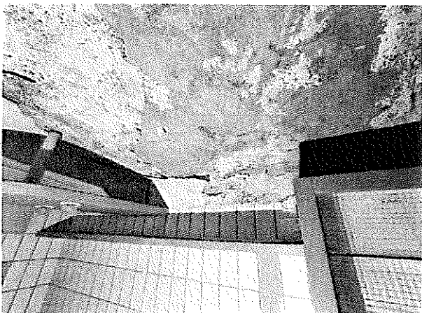
23. vakolathibák a födémszerkezeten
