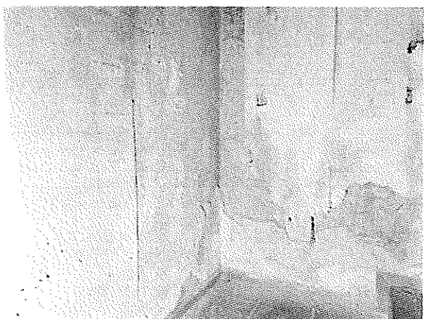
20. vakolathibák a falszerkezeten
