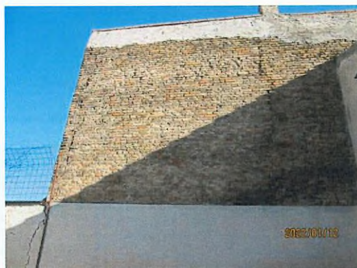
Az épület tűzfala is károsodott.
