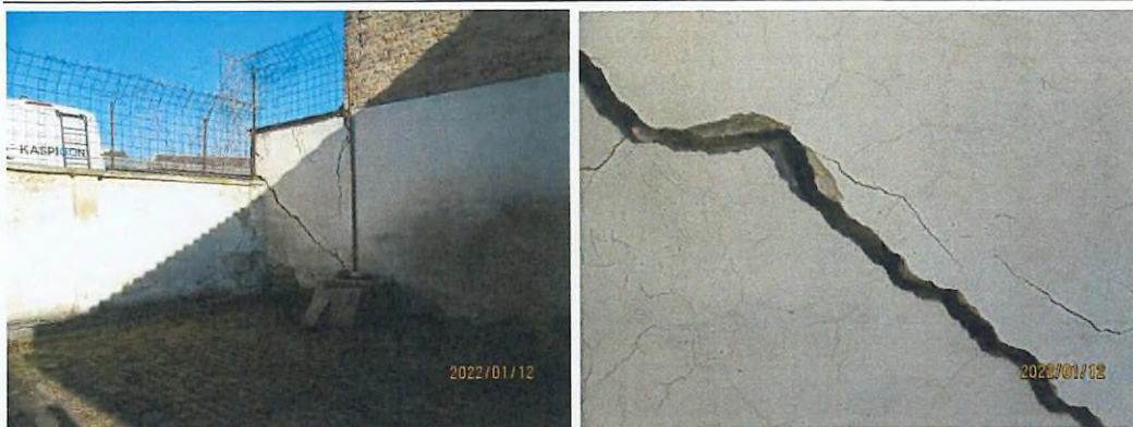
A szomszéd telek felől durván repedt a fal
