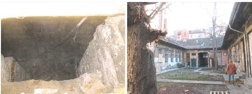
A pince felől a nedvesedés állandó, az udvar állapota is leromlott.
