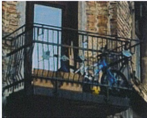
Az első emeleti áttört vasrácsos korlátú erkély történeti-örökségi érték, mind amellet, hogy a korlát nem eredeti.
