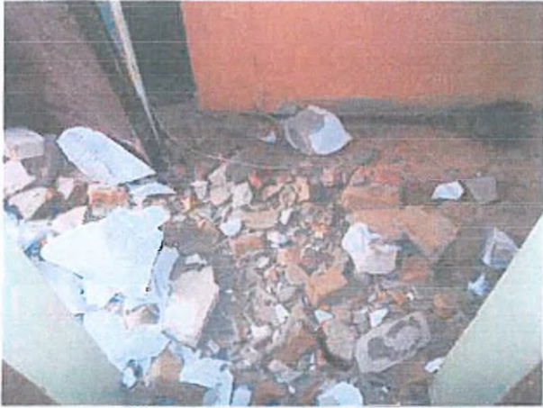
12. építési törmelék a padozaton
