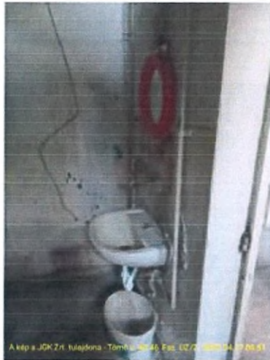
A kép a JGK Zrt. tulajdona - Tömő u. 40-46. Faz. UZ/2 - 2023.04.17.09.51
