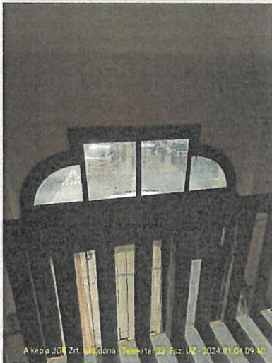
A kép a JGK Zrt. tulajdona - Teleki tér 23. Fsz. UZ - 2024.01.04 09:40
