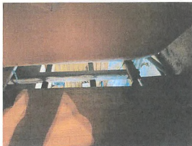
21. kád alatti rész (szabálytalan kiépítés)
