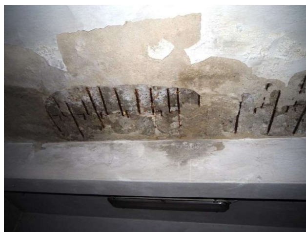
27. korrodált vasbeton födém
