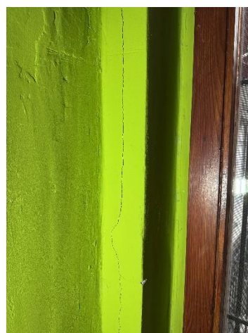
17. kisebb repedés a falazaton
