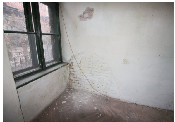
Nedvesedés miatti vakolatleválás
