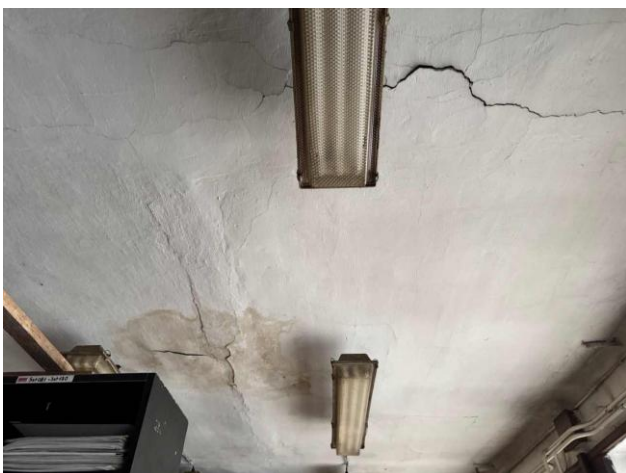
16. repedések a falazaton
