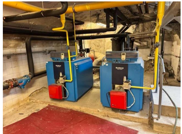
27. gázkazán (Rökk Sz. u. 13. épület)
